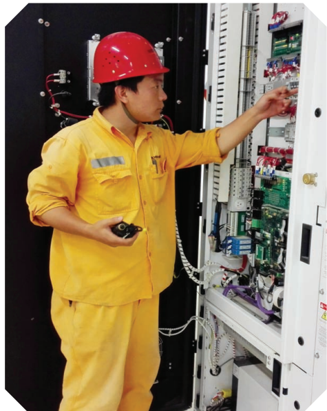
崔萌在检查项目电气设备
